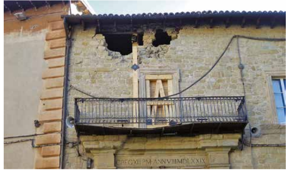
Particolare del Palazzo ducale di Camerino pochi giorni dopo il terremoto del 26 ottobre 2016
